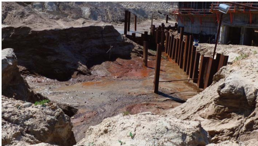
Рис. 3. Осложнения при строительстве (котлован насосной).
