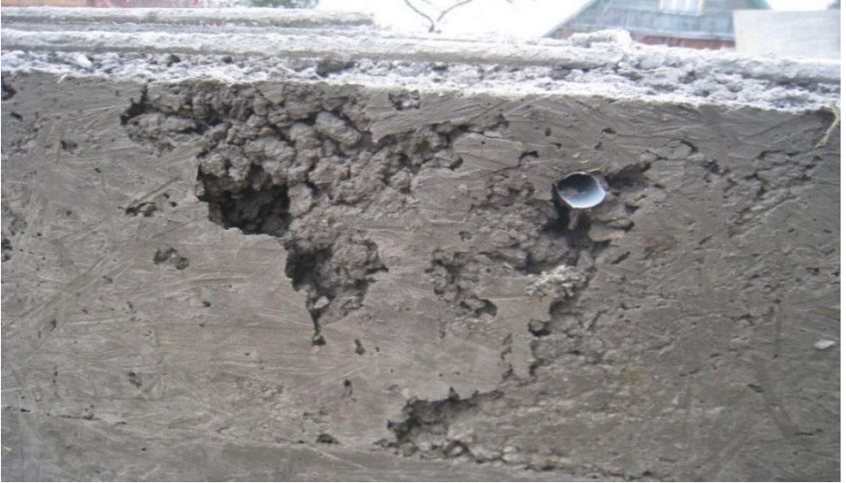
Рис. 3. Пустоты в теле опоры
