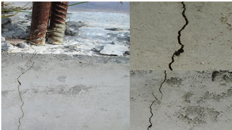
Рис. 7. Разрушение бетона в зоне омоноличивания
