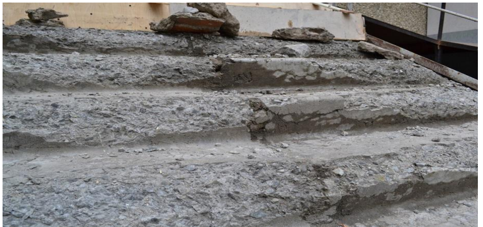
Рис. 4. Морозное разрушение бетона
