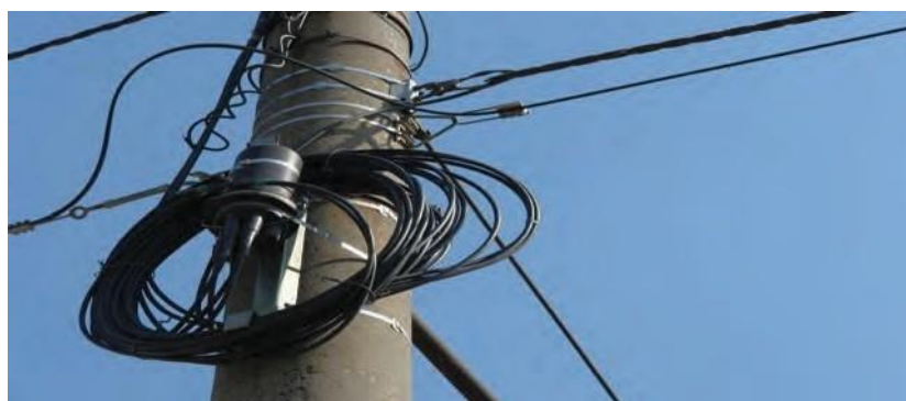
Рис.4 Оптоволоконный кабель на столбе
