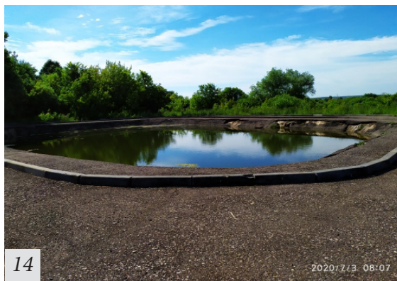
Фото 14. Аккумулирующий водоем (сбор очищенной воды) [2]
