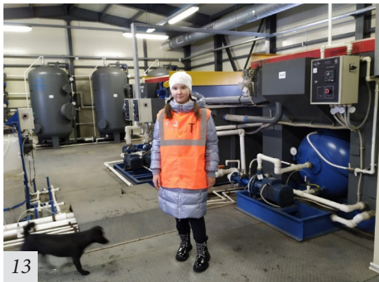
Фото 13. Комплекс очистки ливневых стоков «ЭКО — ЛС — 10/С» Ж/Д станции «Бугульма» [12]
