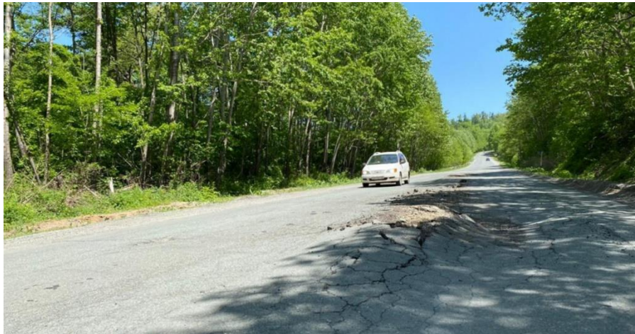
Рис. 4. Пример пучины на автомобильной дороге
