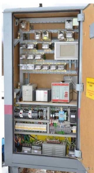
а) шкаф системы АПС-МП
