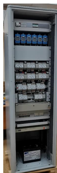
б) шкаф системы АППС
