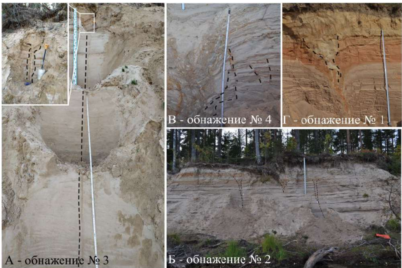
Рисунок 2. Морозобойные трещины: а) максимальная высота (6,9 м), б) полигональная система, в) сбросовые структуры, г) заполняющие породы (фото М.В. Шитова)
