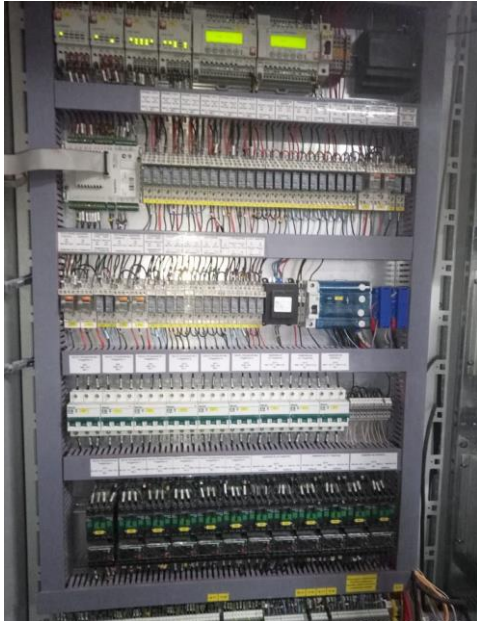
Рис. 5. Коммутационная сторона (питания) блока управления
