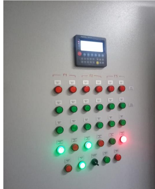
Рис. 6. Управляющий модуль на дверце шкафа
