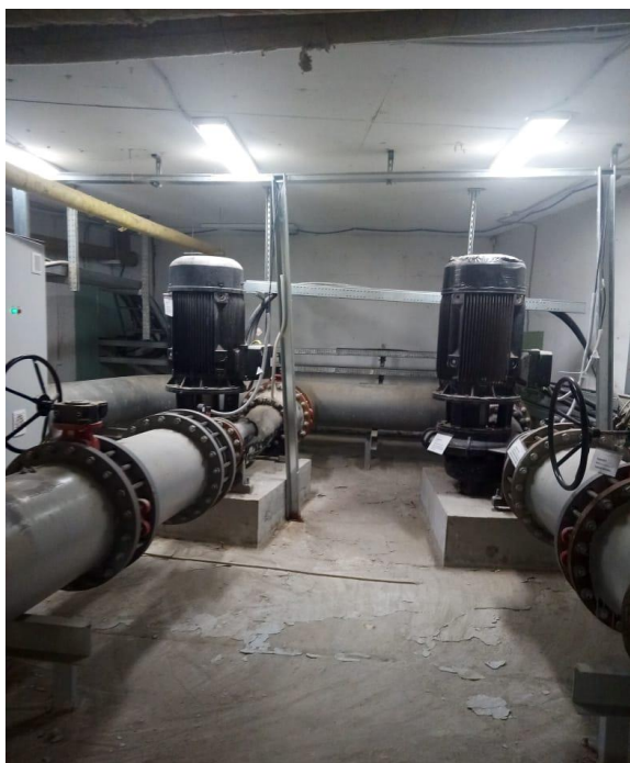
Рис. 3. Трубопровод и насосы внутреннего контура здания
