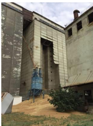
Рис. 4. Результат частичного обрушения конструкций силосного корпуса
