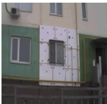
Рис. 2. Устройство теплоизоляционного слоя на фасадной поверхности жилого дома (снимок выполнен при проведении тепловизионного обследования со стороны главного фасада).
