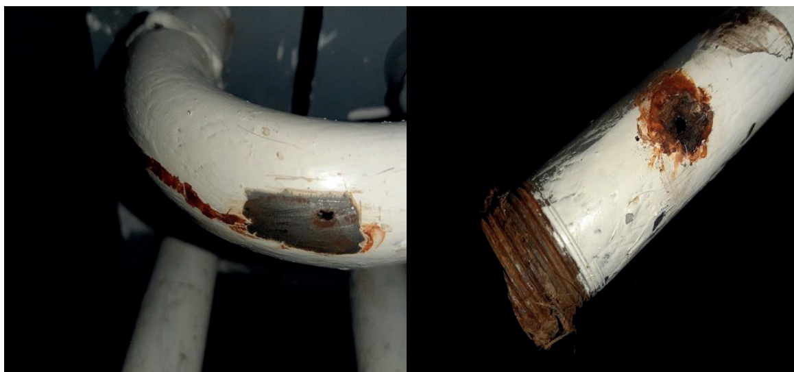
Рисунок 1 – Коррозия отопительных приборов
