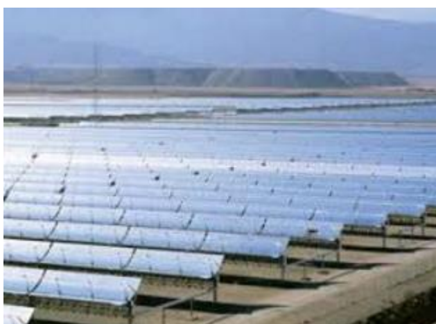
Εικόνα 2.2.1: Ηλιακός σταθμός Andasol Solar Power
