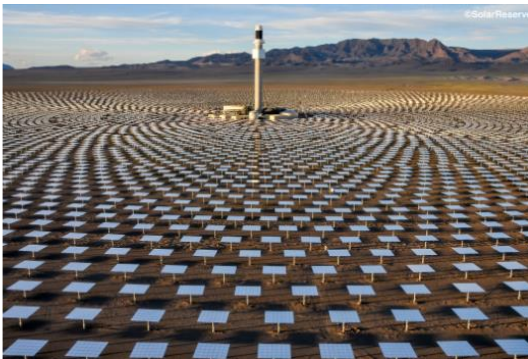
Εικόνα 3.3: Ηλιακός σταθμός Crescent Dunes
