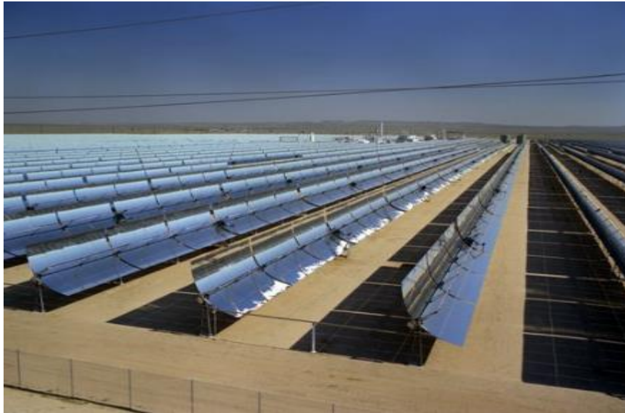
Εικόνα 2.2.2: Ηλιακός σταθμός SEGS III
