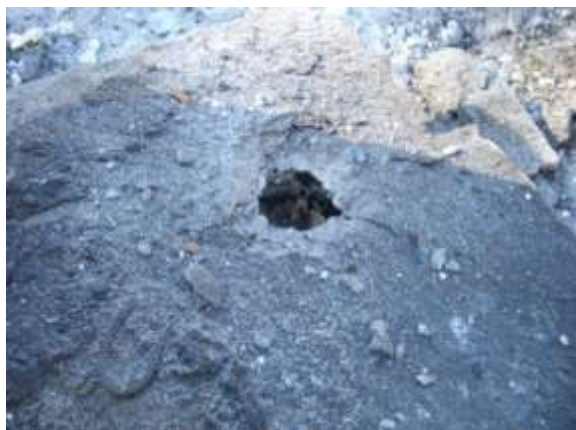
Рис. 1. Отверстие в бетонной плите, пробито КПЭ со скоростью 1865 м/с
