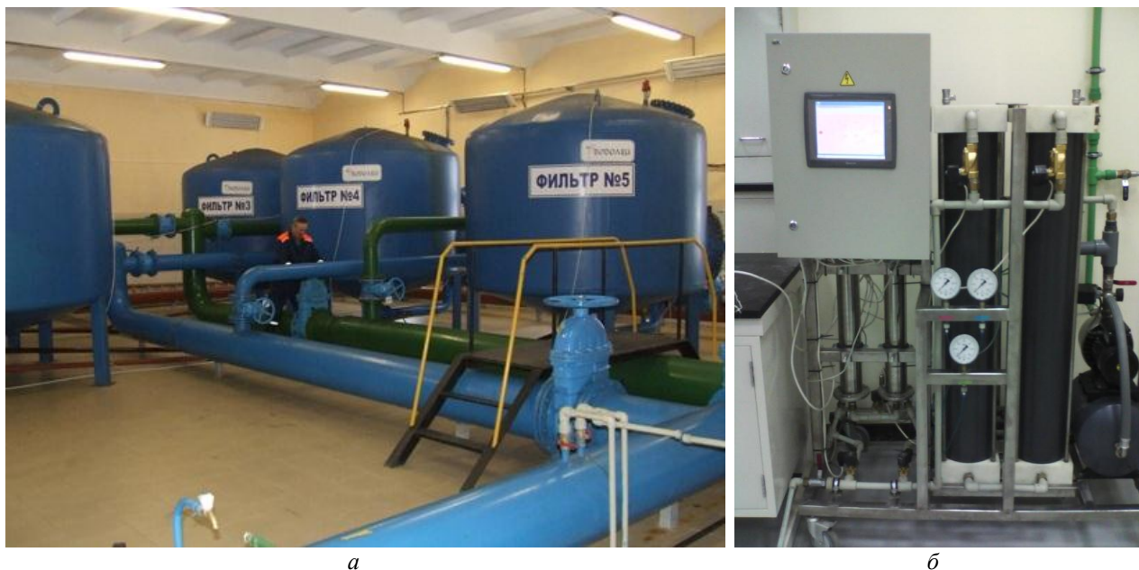
Рис. 5. Установки обезжелезивания Q = 350 \text{ м}^3/\text{ч} (а) и микрофильтрационной очистки воды Q = 1 \text{ м}^3/\text{ч} (б)
