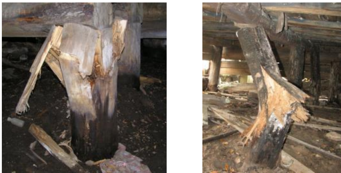
Рисунок 4 – Биопоражение гниением голов деревянных свай под деревянными жилыми домами
