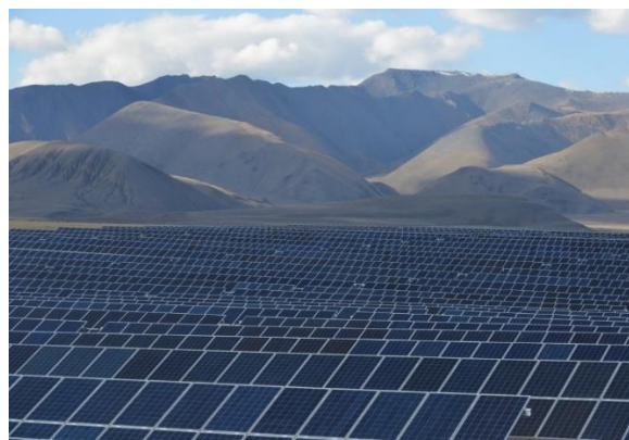
Рис. 2. СЭФЭС мощностью 100 МВт в Нурабадском районе Самаркандской области
