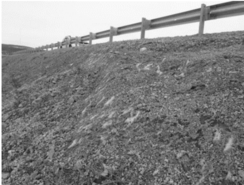
Рис. 2. Многочисленные участки разгрузки воды в теле насыпи
