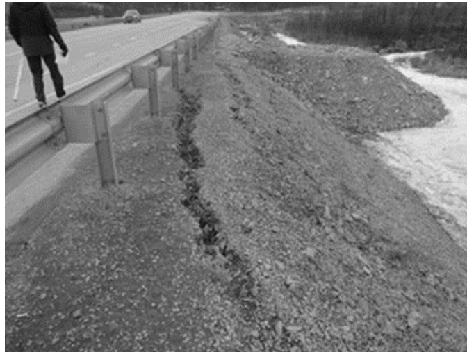
Рис. 1. Разрушение откосов дорожной насыпи
