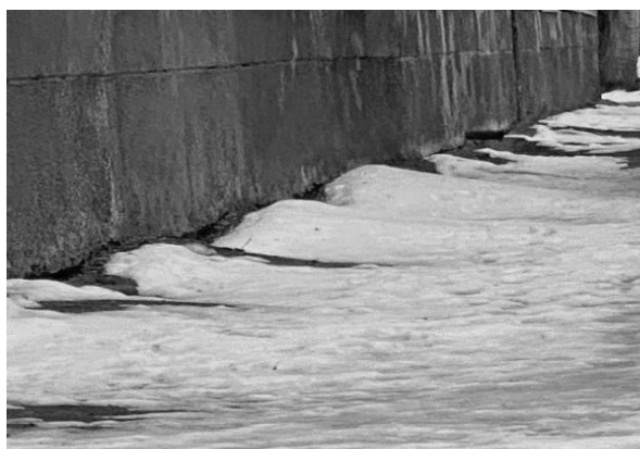
Деформации грунтов под отмосткой здания
