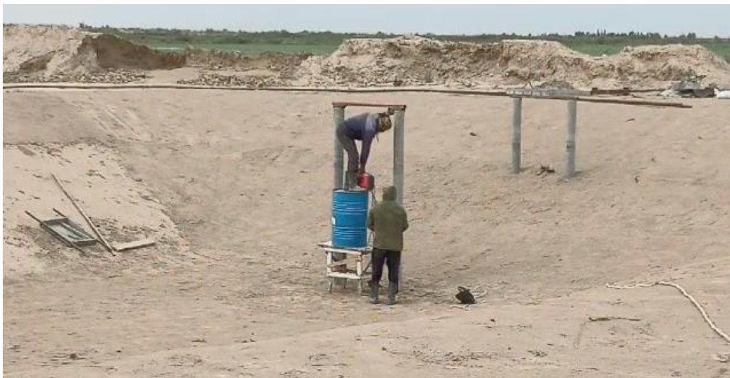
Рис. 4. Котлован водоема. Для возможности очистки дна водоема от постороннего мусора был предусмотрен мостовой заход со спусковыми лестницами, опоры которого видны на фото
