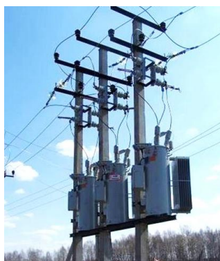
Рис.1. ПАРН на опоре ЛЭП
