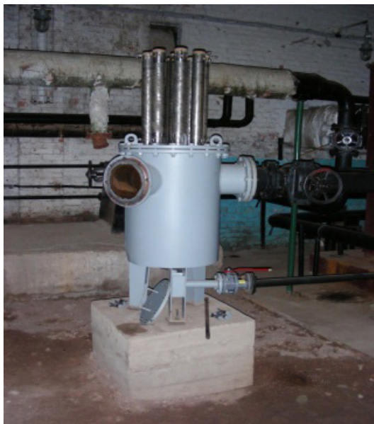
Рис. 4.35. Высокоградиентный магнитный фильтр производительностью 300 м 3 /ч.
