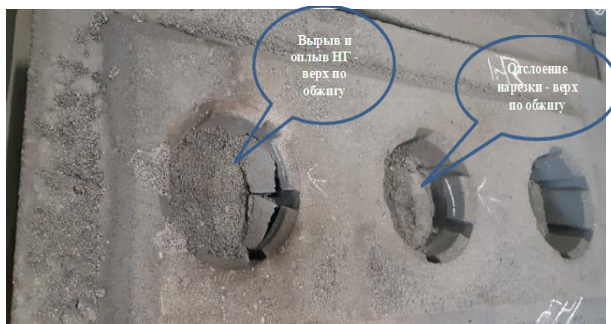
Рисунок.1. Общий вид состояния ниппельных гнезд до чистки.
