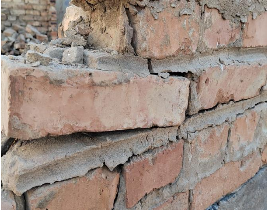
Рисунок 2 Адгезия кирпича и кладочного раствора
