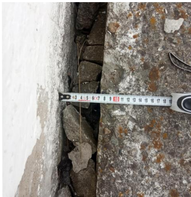
Рисунок 4. Зазор между панелью и отмосткой
