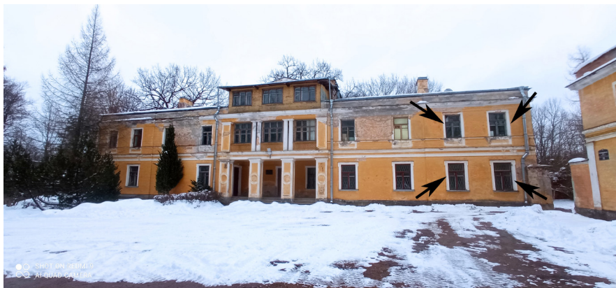
Рис. 2. Петергоф, усадьба Сергиевка, Гофмейстерский корпус (Корпус Б по современной номенклатуре). Вид с западной стороны. Фото апрель 2023 г.
