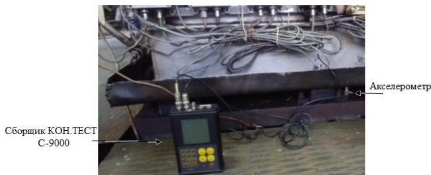
Рисунок 1 – установка акселерометра на фундаменте
