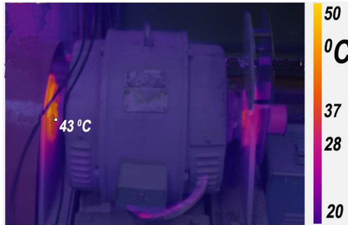
Рисунок 1 – Термограмма генератора БМЗ-4,5/4-М1 в работе (съемка тепловизором Fluke Ti 400)
