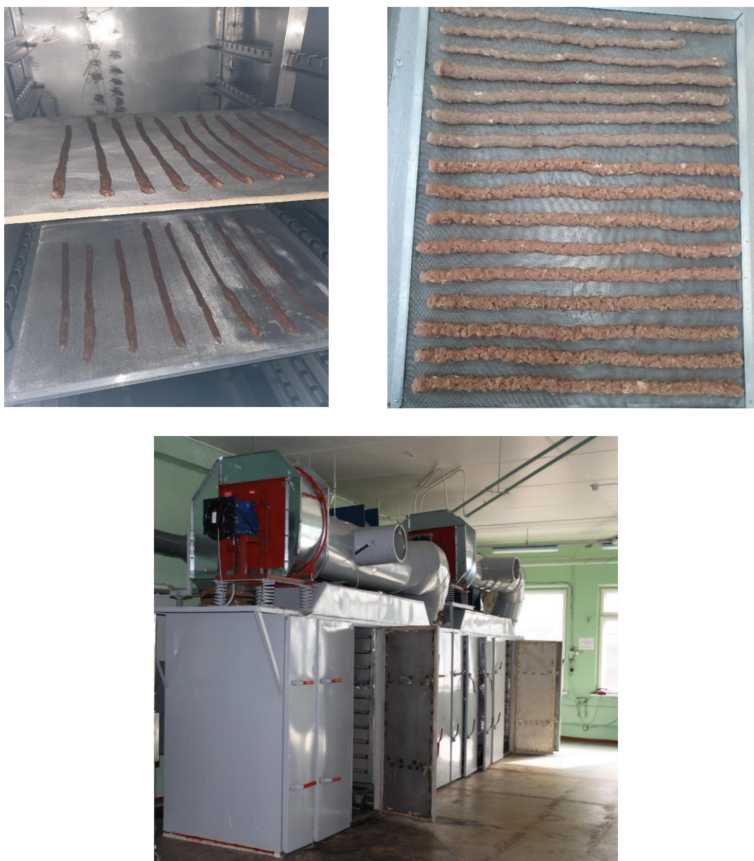
Рисунок 2 – Сушка снеков в универсальной коптильно-сушильной установке
