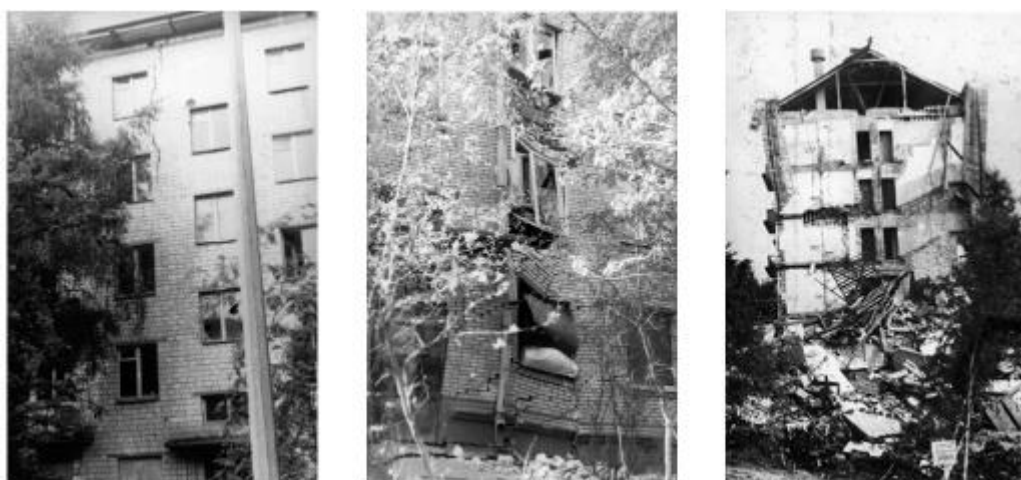
Рис. 6. Развитие деформаций и разрушений жилого пятиэтажного здания. Фото Л.Г. Черткова
