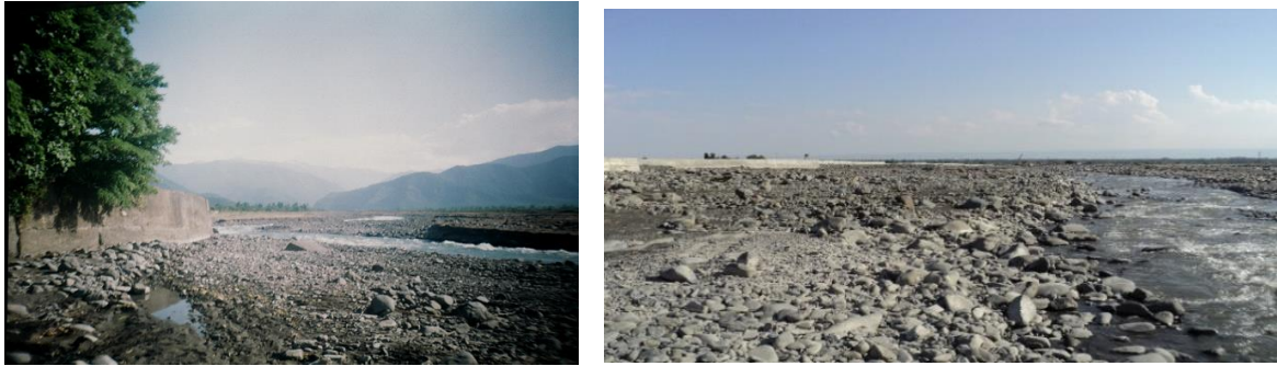
Рис.1. Разрушение водозаборной плотины на р. Катехчай (селевым потоком 17.08.2011 г.)
