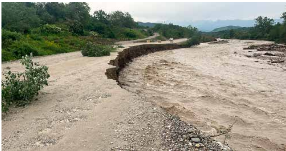
Рис. 3. Размытое полотно обездной грунтовой автодороги паводковыми водами р. Нальчик
