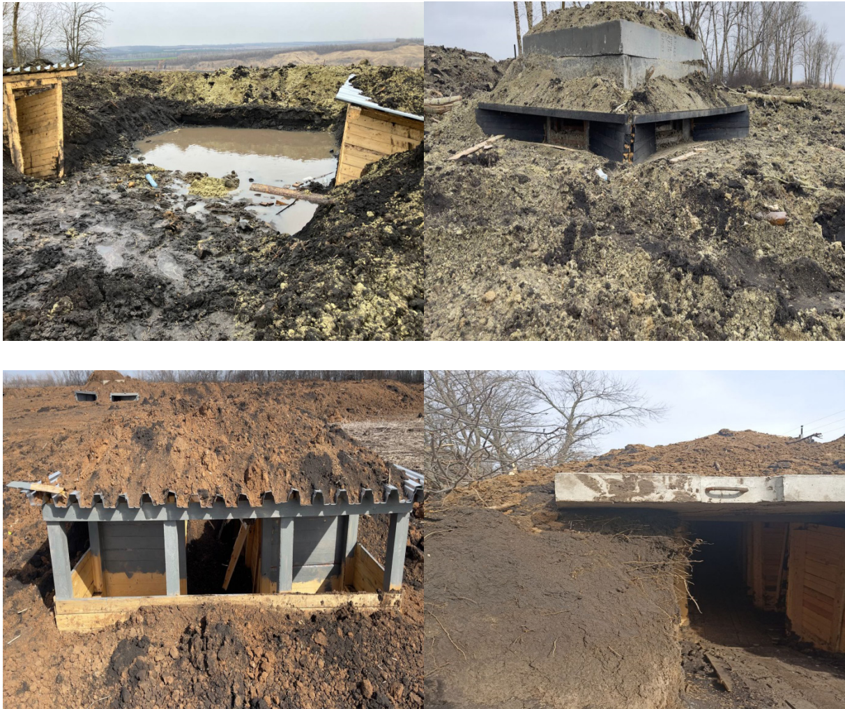
Рис. 4. Выявленные дефекты: а) затопление места под бронемашину; б) недостаточное заглубление бронекотла; в) отсутствует засыпка грунтом от флангового огня; г) перекрытые щели: выполнено в одну плиту (со слов военных, при попадании снаряда 155 мм, перекрытие не выдерживает удар)
