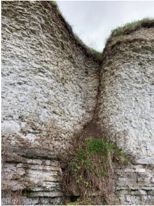
Рис. 2. Заполнение трещины делювиальным материалом
