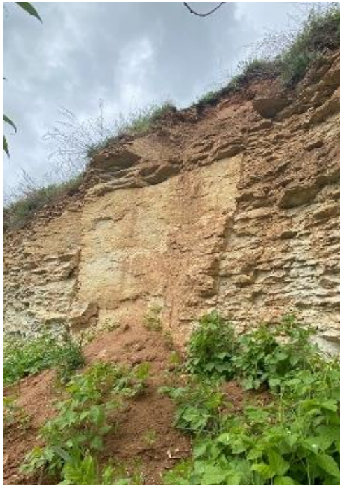
Рис. 4. Поверхность стенки обнажения в зоне свежих обвално-осыпных явлений на правом берегу р. Великой
