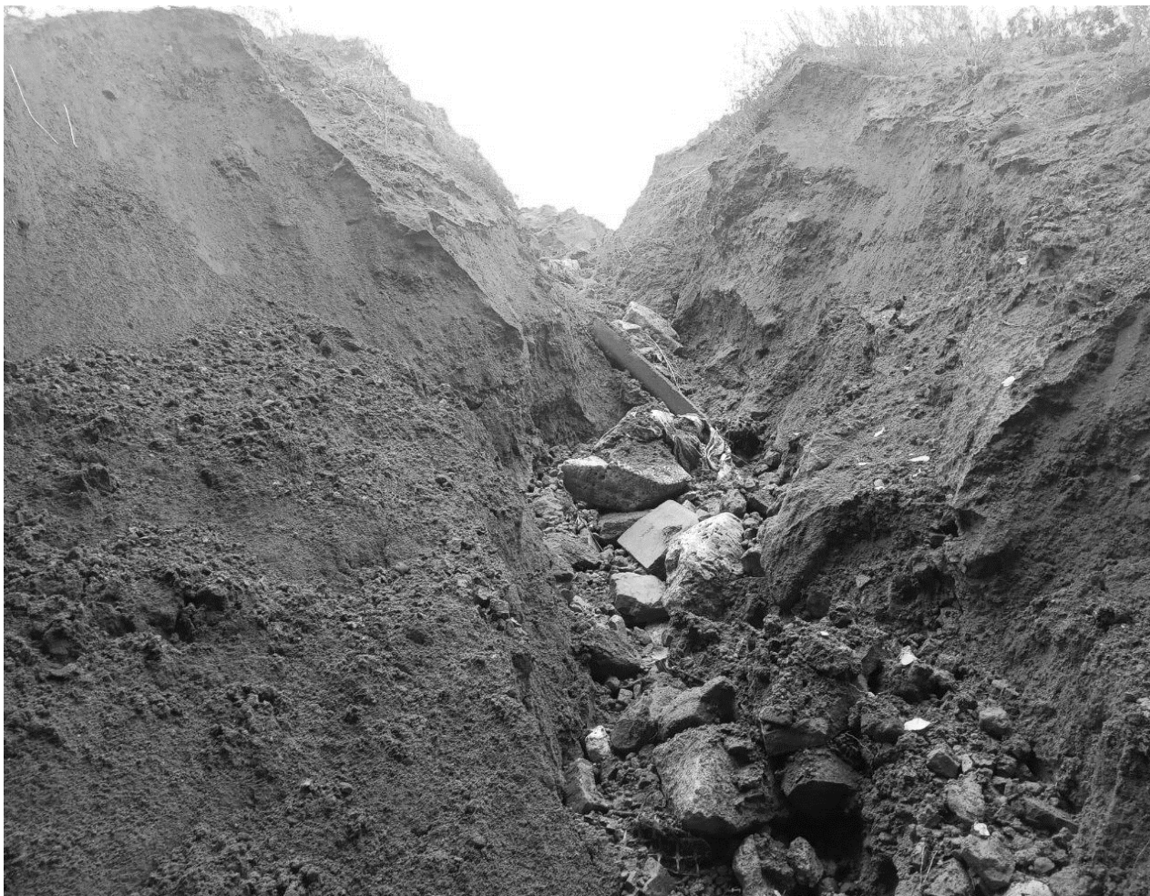
Рис. 1. Фрагменты бетонных конструкций в тальвеге молодого оврага
