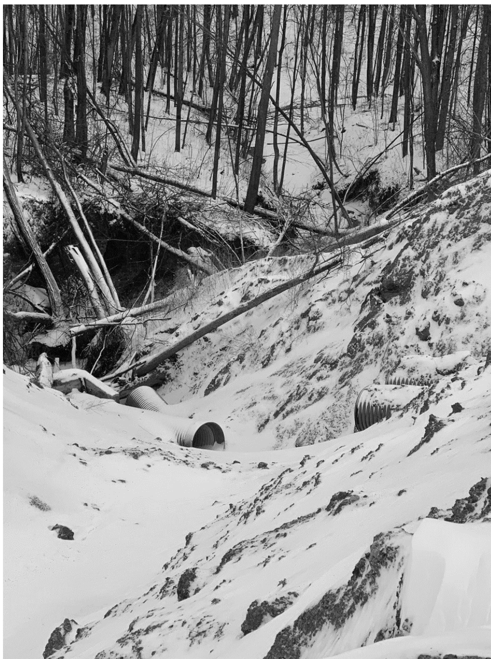
Рис. 3. Разрушение дренажной системы
