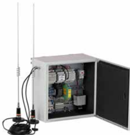
Рисунок 1. Шкаф сбора и передачи данных ШСПД.
