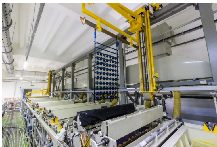
Рисунок 1 - Автоматическая линия нанесения декоративных электрофоретических покрытий
