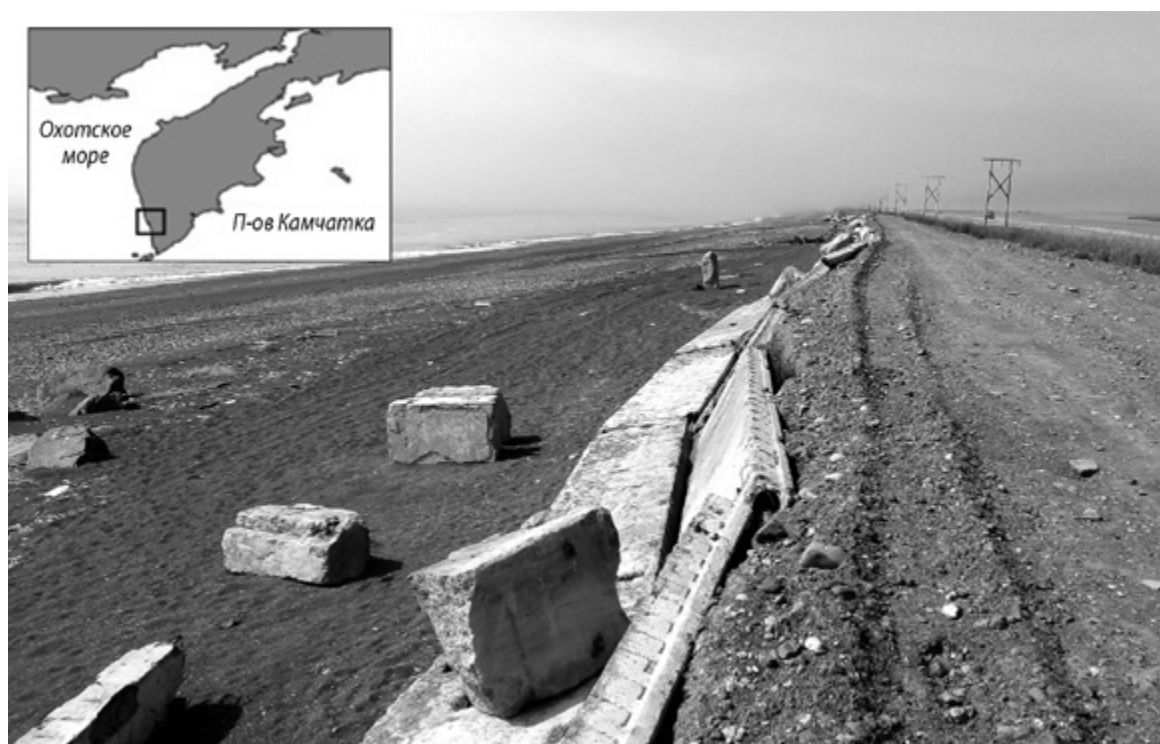
Рис. 3. Защита дорожной насыпи на Косе Октябрьской (Охотское море) бетонными плитами
