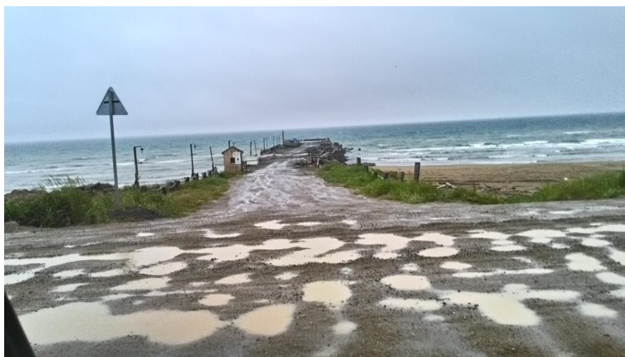
Рис. 3. Одиночный пирс рыболовной компании. В его основании – каменная наброска, перекрывающая вдольбереговой поток наносов. Фото Г.Н. Дзена
